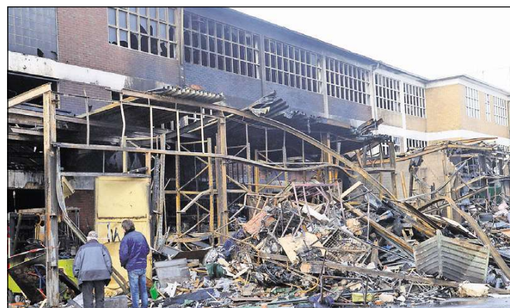
Trümmerhaufen: Durch das Feuer in den von einer Verwertungsfirma genutzten Halle entstand 500 000 Euro Schaden. Foto: Siemer
